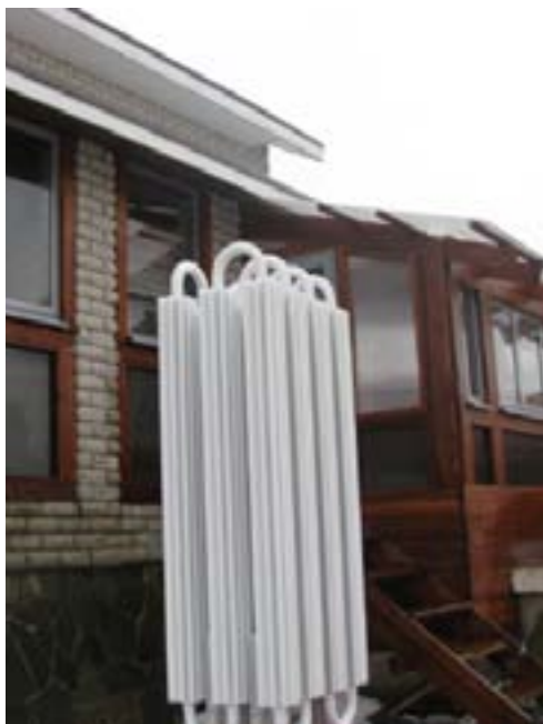
Рис. 18. Отопление коттеджного поселка. Атмосферный испаритель для теплового насоса в работе
